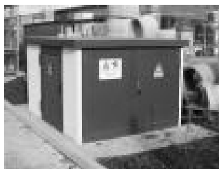
Netzstation (Trafohaus) Sternpunkt geerdet
